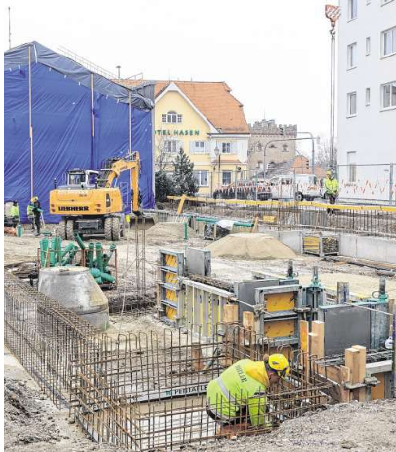
Der westliche Teil des Theaters Schauburg wurde bereits abgerissen, die Fundamente für den Neubau sind gelegt. Der Gebäudeteil an der Ganghoferstraße mit seinem charakteristischen Stufengiebel (hinten) bleibt hingegen erhalten. Fotos: Mathias Wild
