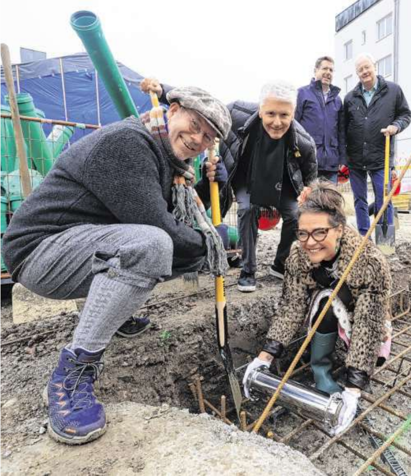
Eine Zeitkapsel aus Metall wird unter dem neuen Theater Schauburg vergraben. Beim Spatenstich wurde sie von Thomas Garmatsch (links) und Simone Dopfer (rechts) vom Kulturwerkstatt-Team sowie Wolfgang Kastl, Vorstandsvorsitzender der Antonie-Zauner-Stiftung (Mitte) in der Baugrube platziert.
